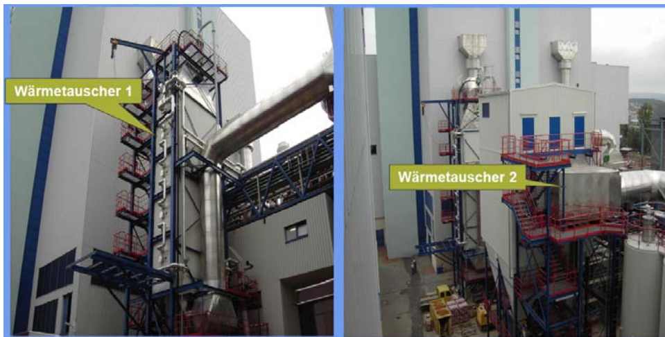
Abb. 11: Abgas-Wärmetauscher 1 und 2 im MHKW Kassel [6].
