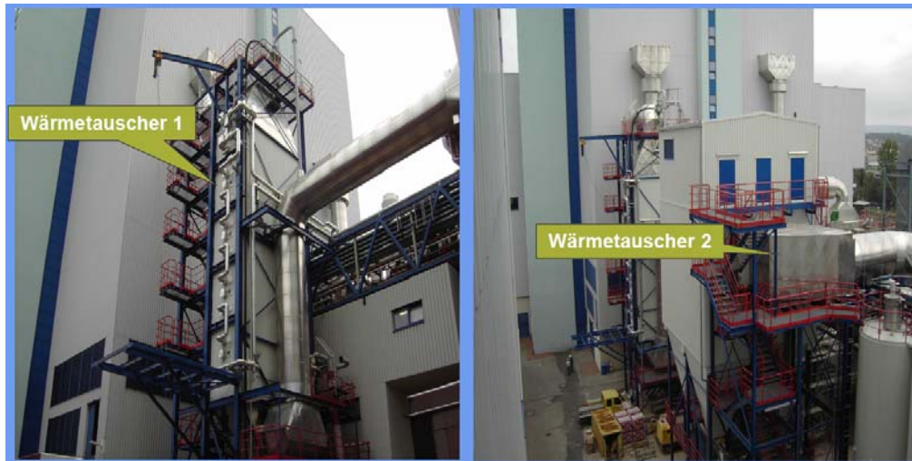
Abb. 11: RG-Wärmetauscher 1 und 2 im MHKW Kassel [6].
