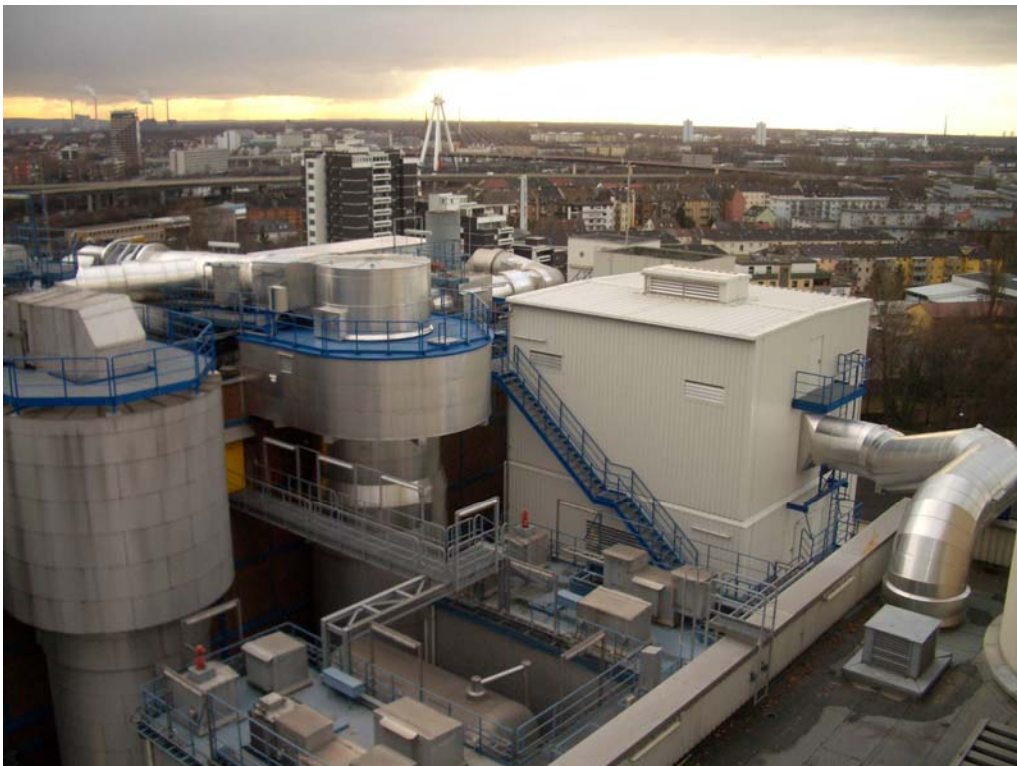
Abb. 4: Sprühabsorberkopf und Filter-/Reaktorgebäude
